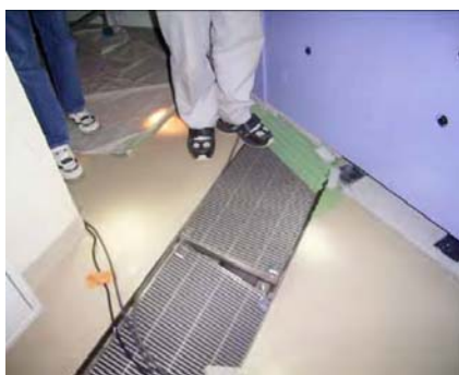
図 1b. MLF と西側増設建屋の接続部分の沈降と破損
